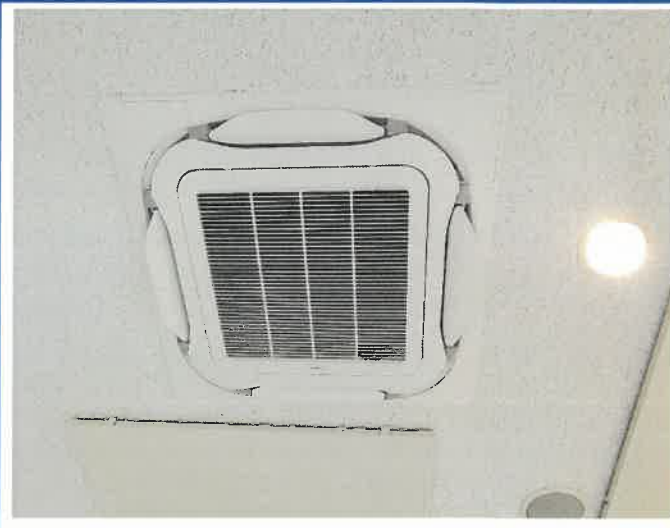
●各階エアコンフィルター
